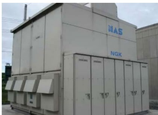
大型蓄電システム施設
